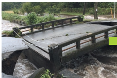
橋梁が破損した、赤堀川の岡橋(石那田町)
